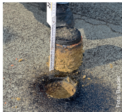
Vor der Flachdach-Sanierung erfolgt eine umfangreiche Analyse des Zustandes der einzelnen Lagen.
